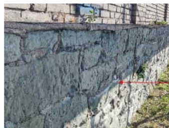
loser Putz, ausgewitterte Fugen
