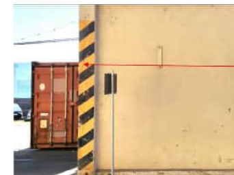
Abplatzungen und Risse
