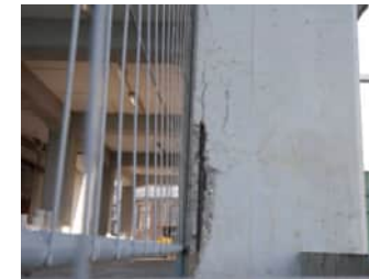
Abplatzungen und Risse
