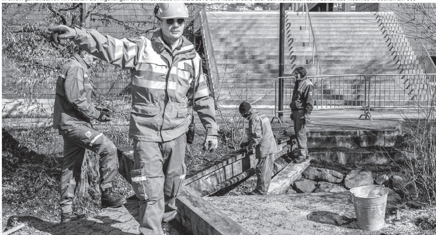
In einem gemeinsamen WK bauten die Angehörigen des Zivilschutzes im März 2018 eine neue Brücke über den Mühlebach beim Schulhaus Riedwies in Uetikon am See
