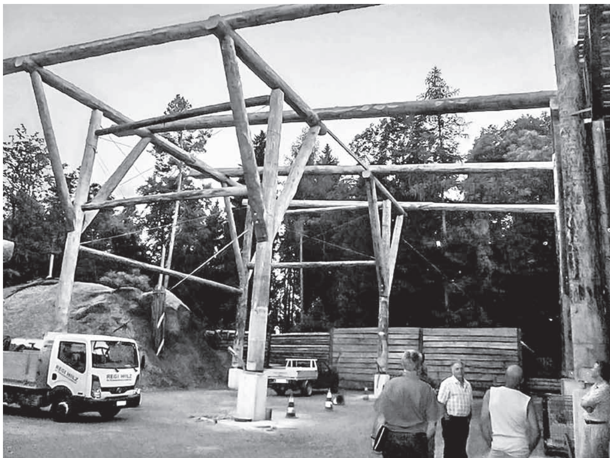
Bau der Lagerhalle im Energieholzzentrum im Jahr 2010: Dank dieser Lagerhalle kann das Energieholzzentrum qualitativ hochstehende Trockenschnitzel anbieten, welche in Wohngebieten keine Wasserdampfahne erzeugen.
